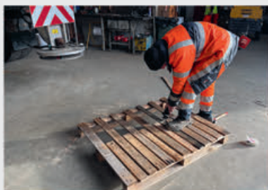
Fabrication de panneaux d'affichage
